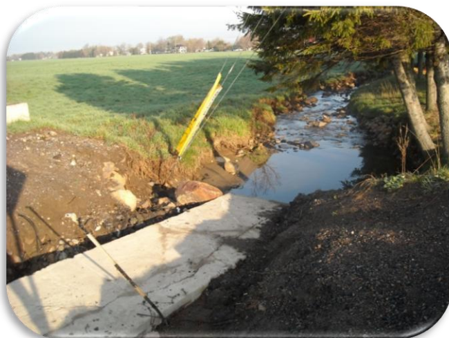
Photo 3.2 Ponceau effondré dans le tributaire tout juste à l'amont de T-2
