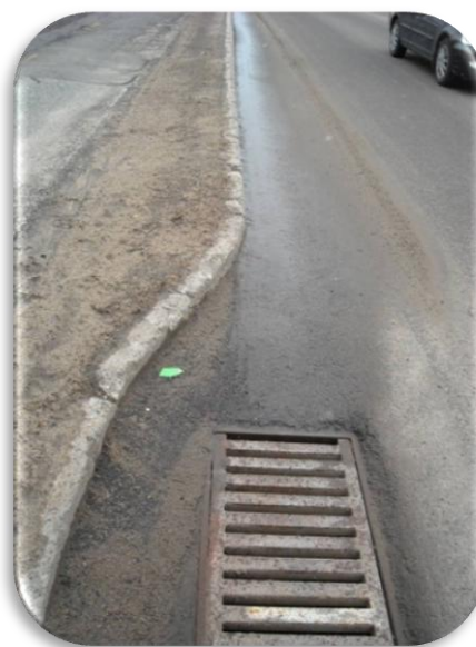
Photo 2.6 Matières solides restantes en bordure de la rue du Domaine, le 8 avril 2009
