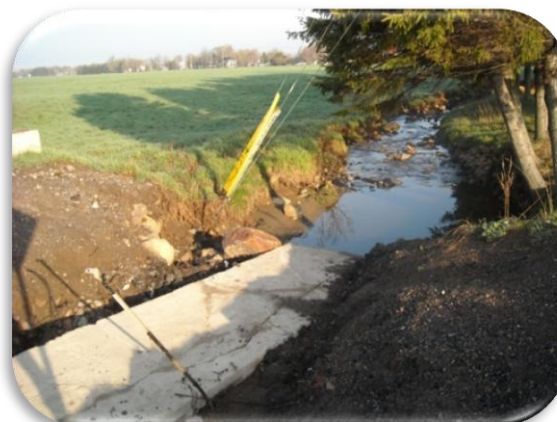
Photo 5.10 Ponceau effondré dans le tributaire tout juste à l'amont de la station T-2
