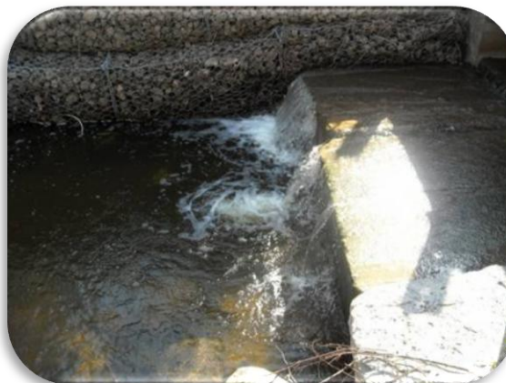
Photo 7.4 Seuil infranchissable pour les poissons
