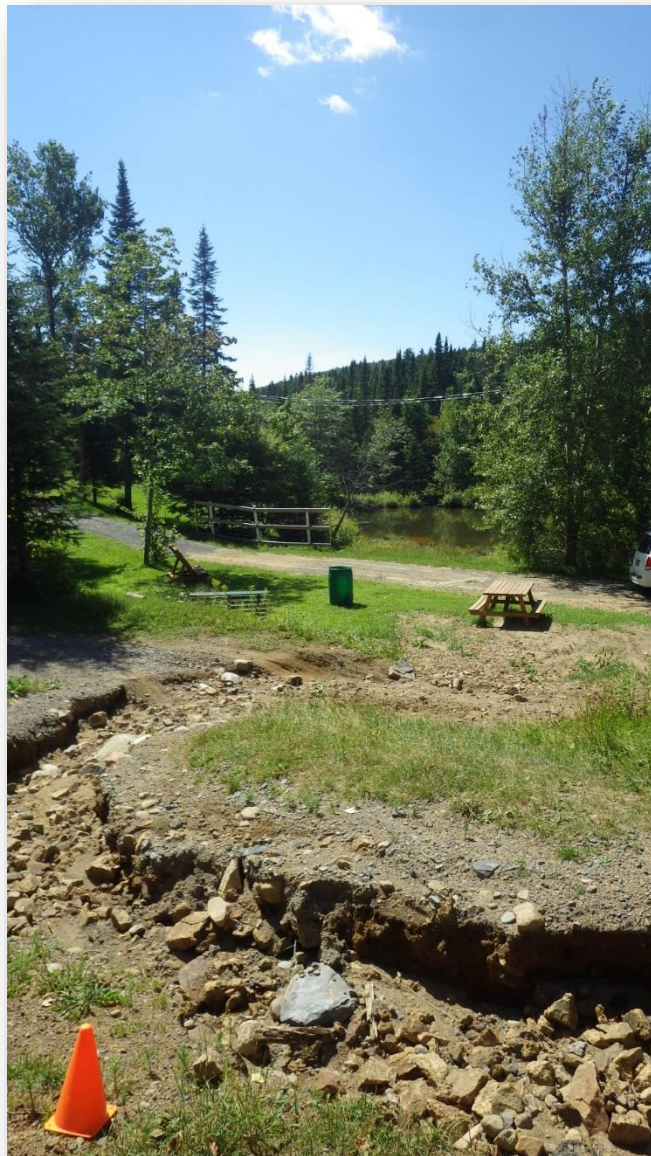
Photo 3 : Foyer d'érosion aux Sentiers du Moulin, 2016
