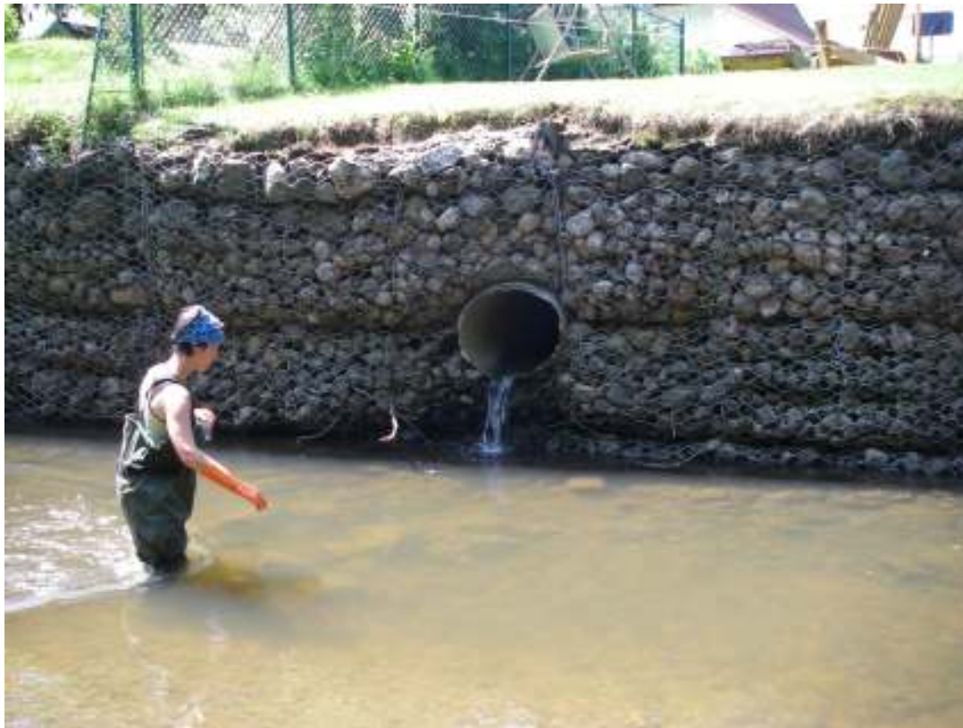
Photo 1 : Échantillonnage de la conduite CPLO211 en juillet 2009
