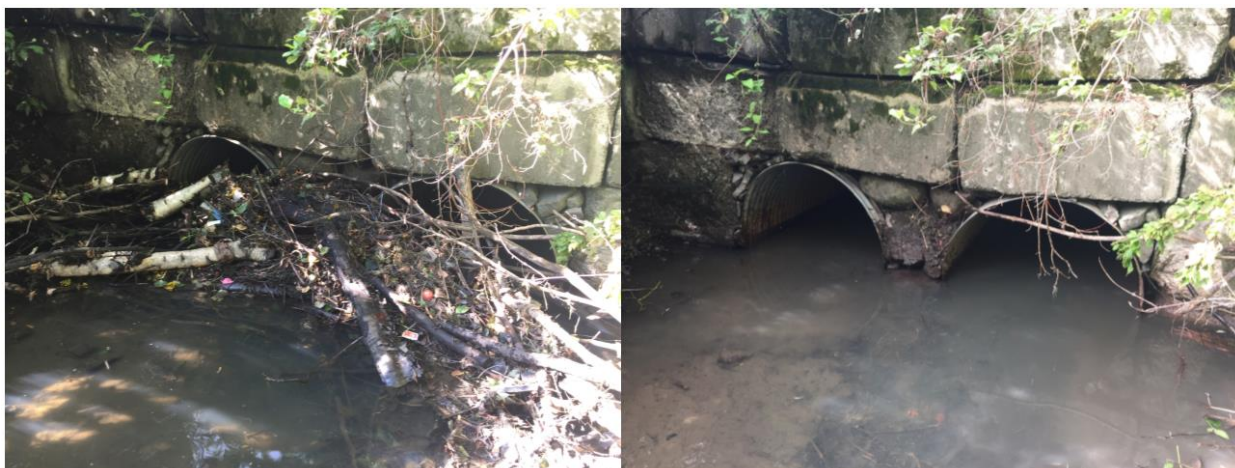
Figure 37 : Embâcle 1 (à gauche : avant le démantèlement; à droite après le démantèlement)
