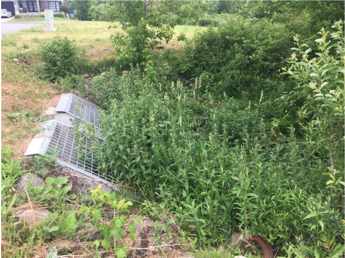
Figure 14 : Ponceau double en tube sous la rue du Grand-Duc (ruisseau du Mélézin - T2)
