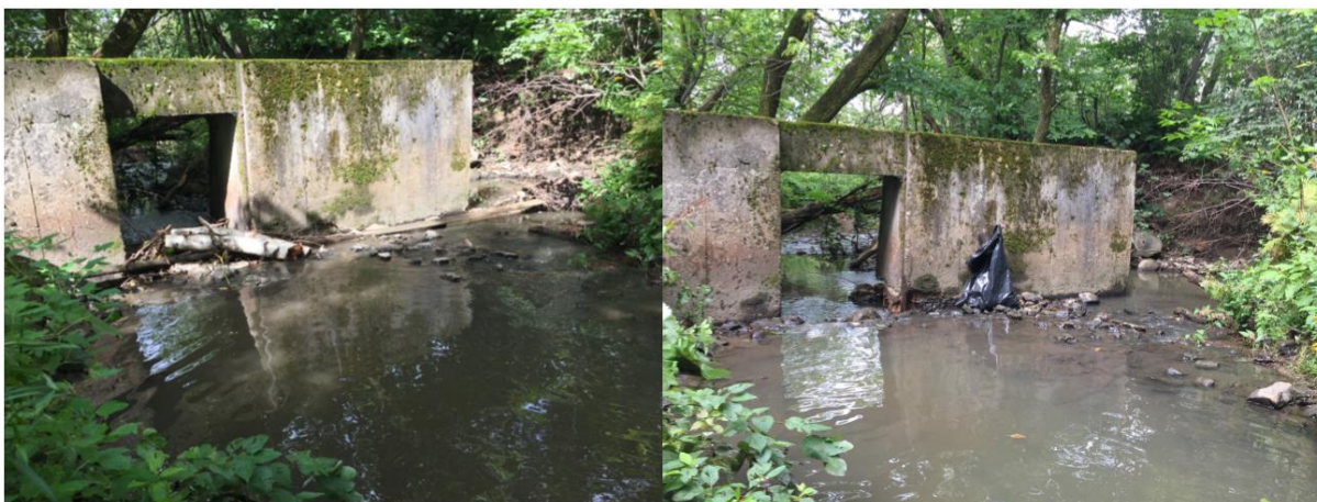
Figure 38 : Embâcle 2 (à gauche : avant le démantèlement; à droite après le démantèlement)
