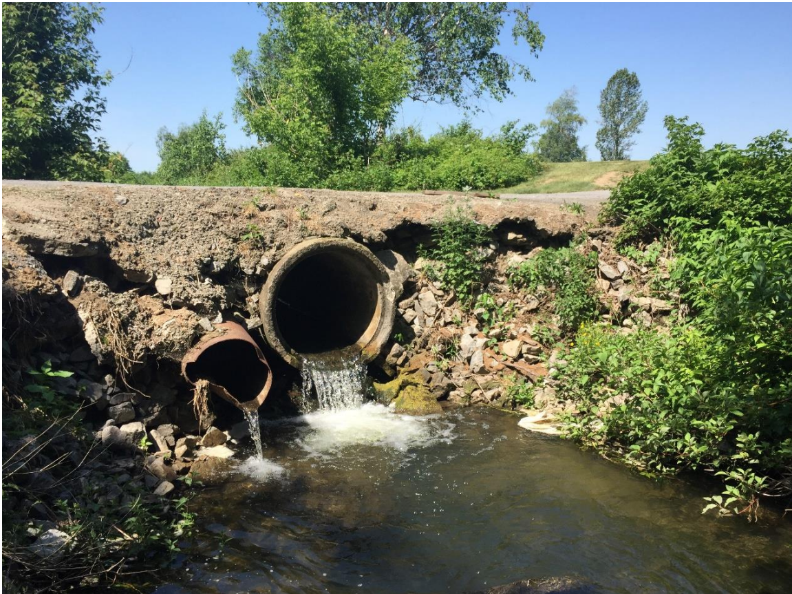
Figure 13 : Ponceau double en tube à l'exutoire du terrain de golf (ruisseau Peuvret – T1)
