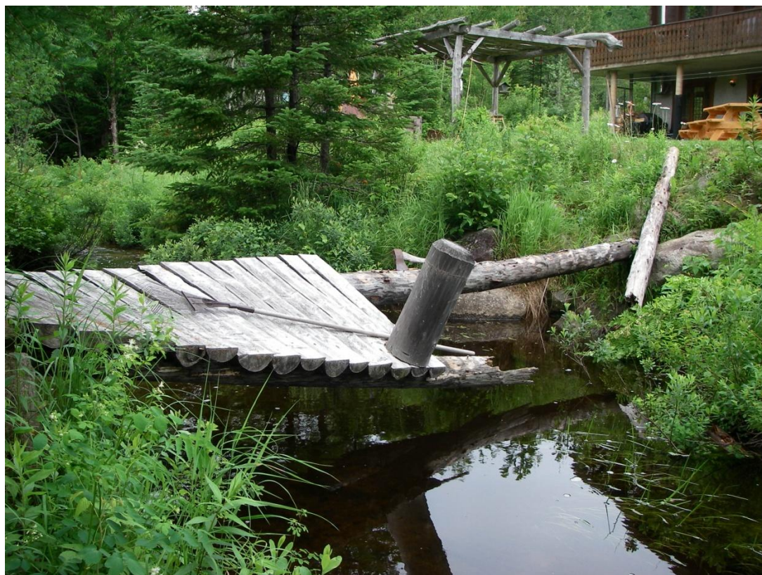
Photo 4 : Pont effondré dans le tributaire 1 près du lac Écho
