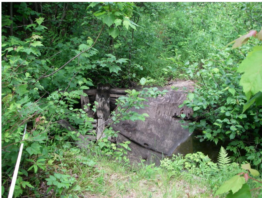
Photo 5 : Pont effondré dans le tributaire 1 près du sentier national
