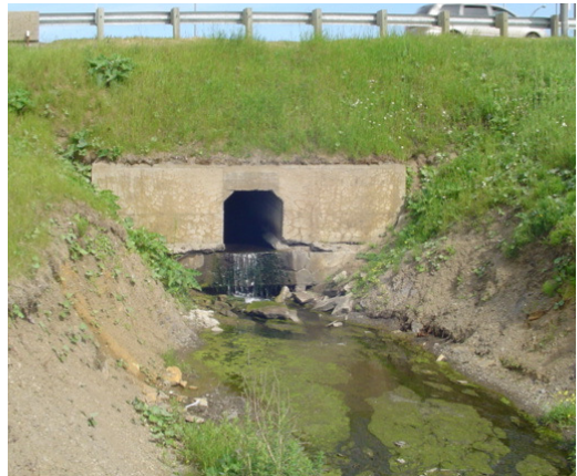
Figure 12. Érosion des bords du fossé de l'avenue du Bourg-Royal. (Crédit CAGEQ)
