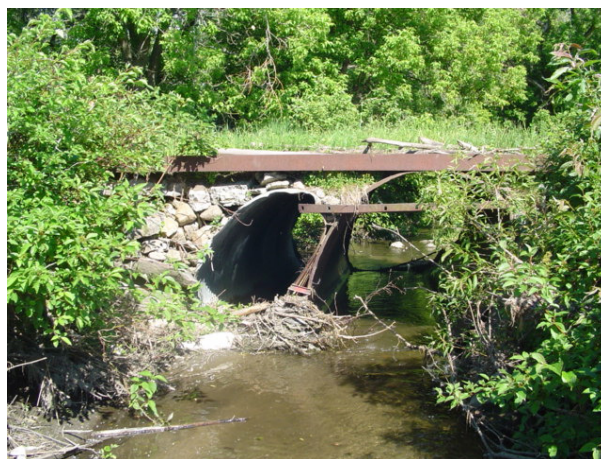
Figure 18. Ponceau endommagé dans le secteur agricole. (Crédit CAGEQ)
