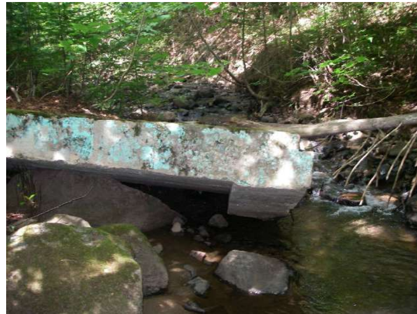
Figure 34. Pt-6 : Ancien barrage franchissable, car les dalles de béton ne prennent pas toute la largeur de la rivière.
