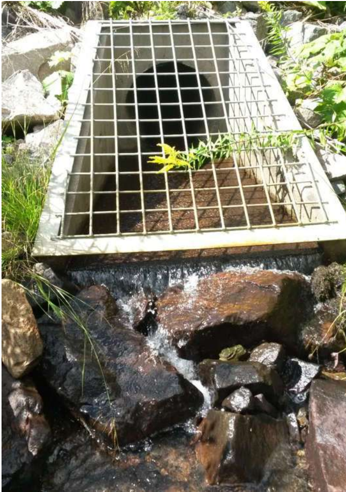
Figure 105. Pn-16, un ponceau infranchissable pour de multiples raisons, découlant surtout du fait qu'il a été installé trop haut. Il constitue probablement un obstacle à l'allopatrie.
