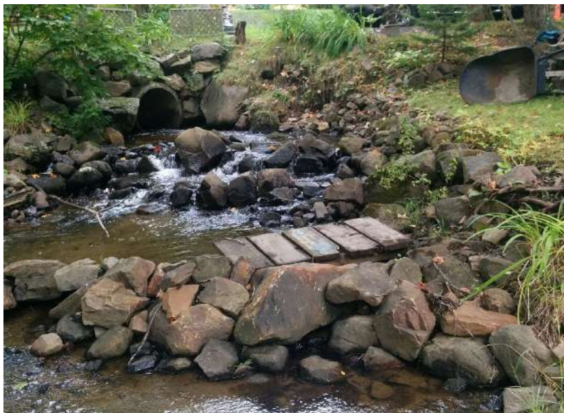
Figure 41. Sa-2 et l'aval de Pn-7 : Trois seuils en blocs, dont deux sont infranchissables et devraient être améliorés en créant une échancrure en déplaçant les blocs.
