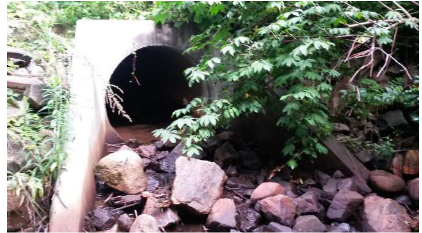
Figure 94. Ponceau Pn-13b, qui est rendu infranchissable par les blocs sur le tablier de béton. Retirer les blocs du centre pour laisser un chenal central.
