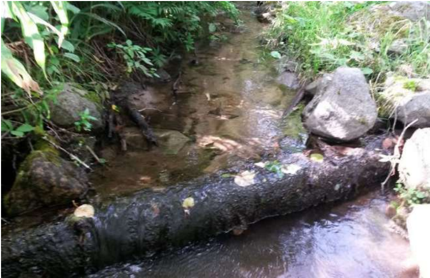
Photo 1. Seuil en bois (Se-8) qui aurait besoin d'une échancrure pour creuser une fosse et accélérer le courant en amont.
