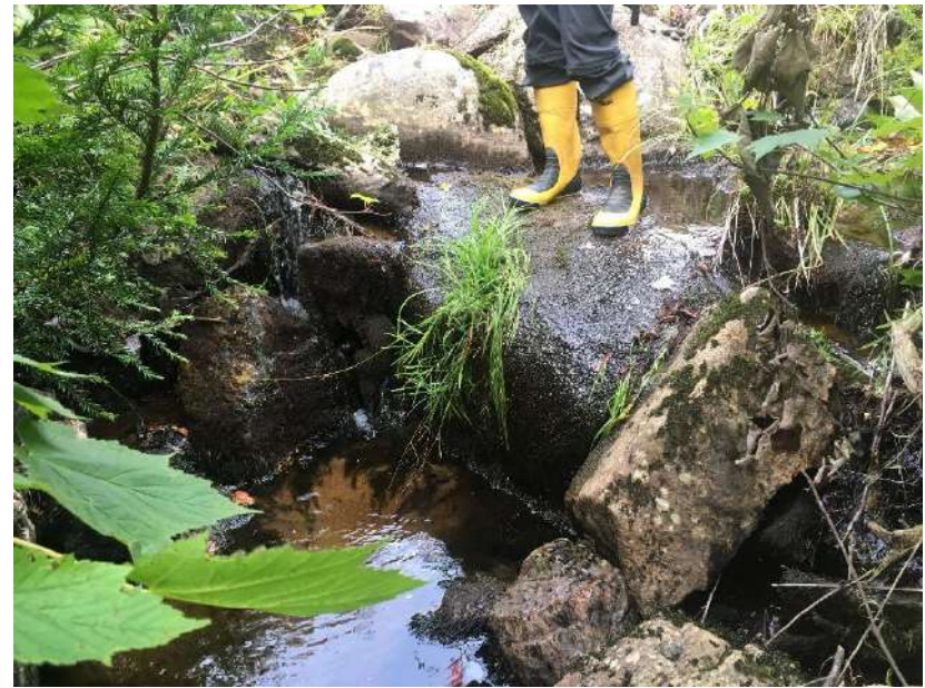
Figure 68. Se-l-1, seuil en béton, d'une hauteur de 65 cm, probablement difficile à franchir, même à l'automne. Nous pourrions ajouter un seuil au pied pour faire remonter le niveau de l'eau.
