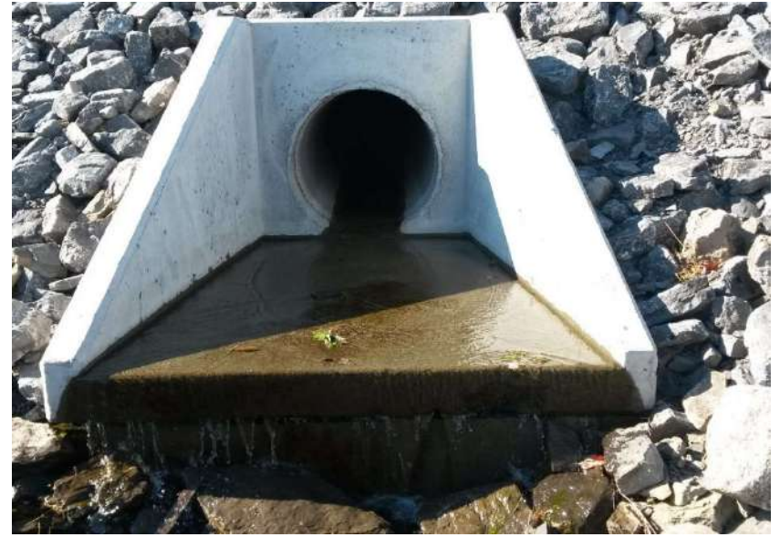
Figure 154. Pn-18, ponceau infranchissable de 30 mètres. Le radier de béton est supposé être enfoui sous le lit de la rivière, alors qu'il dépasse de 42 cm. Il n'y a aucune fosse au pied du ponceau.
