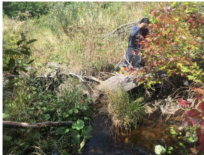
Figure 65. Em-d, embâcle à nettoyer, enlever seulement le nécessaire afin de le rendre franchissable, ainsi que le pneu.
