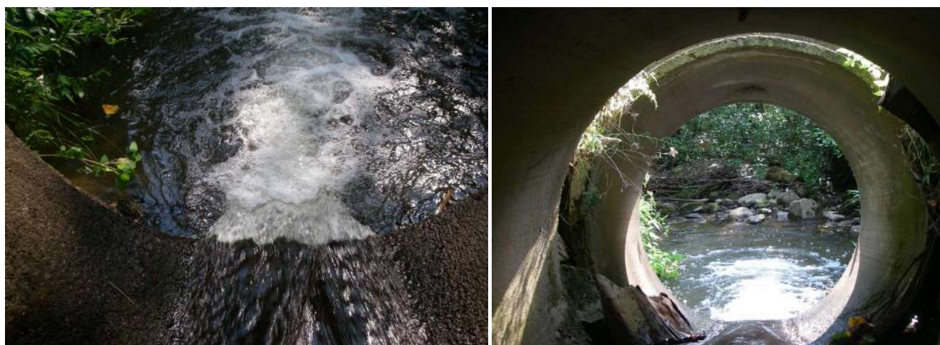
Figure 171. Pn-2. Gauche : la chute de 20 cm. Droite : Vue de l'intérieur, section décrochée.
